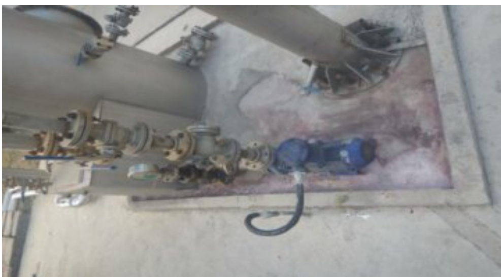
图 4.5-1 厂区喷淋塔地表
